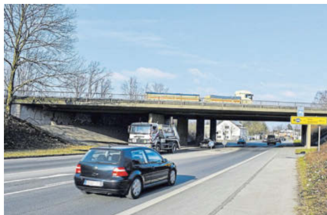
Die hier auf einem Archibild zu sehende Brücke über die Borchener Straße muss ersetzt werden.
